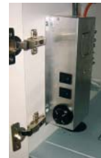
Lämpöaltaan virtakytkin ja termostaatti
