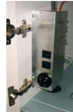
Lämpöaltaan virtakytkin ja termostaatti
